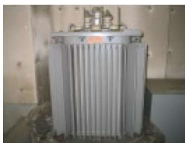
高圧トランス
